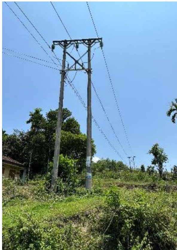
Đường dây trung áp
