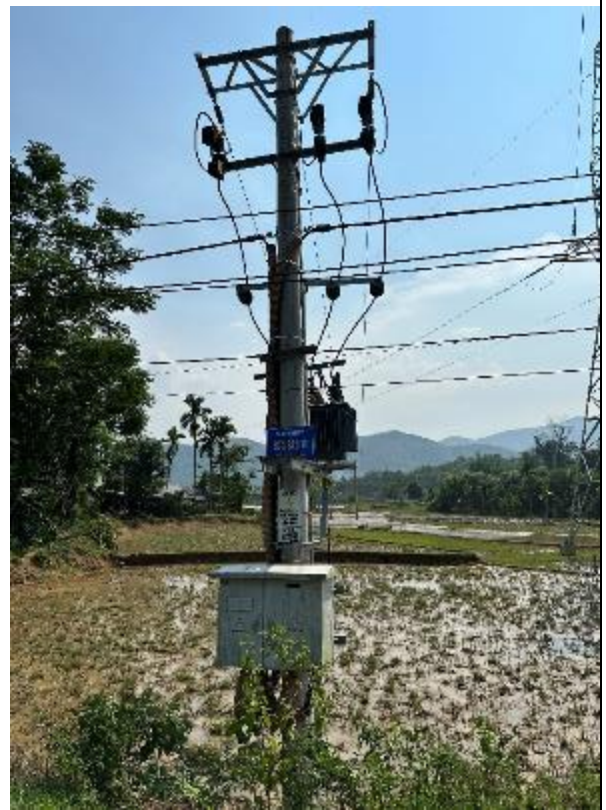
Trạm biến áp
