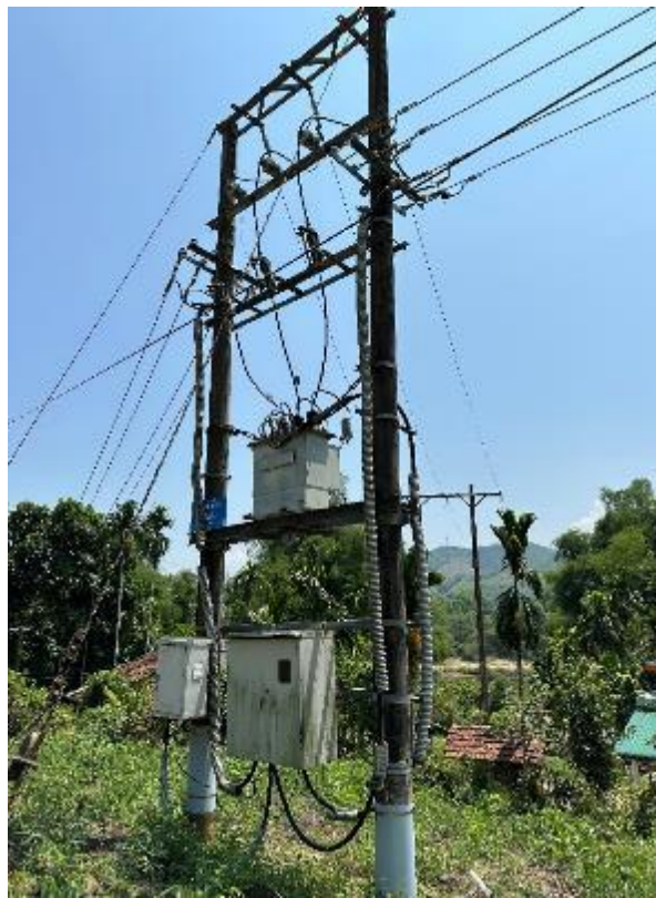
Trạm biến áp
